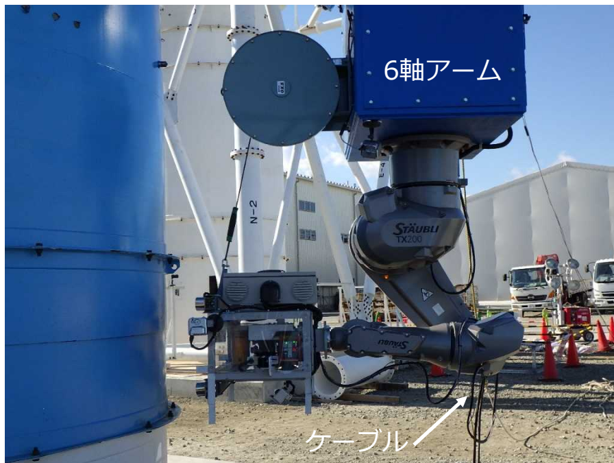
6 軸アーム配線状況
